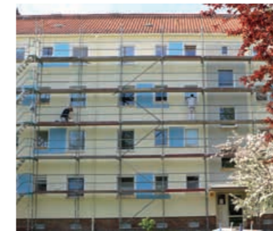
→ Die Bienertstraße 23–27 erhielt im Frühjahr einen neuen Fassadenanstrich. Zuerst wurde die Straßenseite fertiggestellt, anschließend mit detaillierter Gestaltung die Hofseite.
